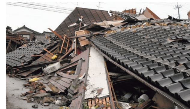
珠洲市の倒壊した家屋 写真提供／朝日新聞社
