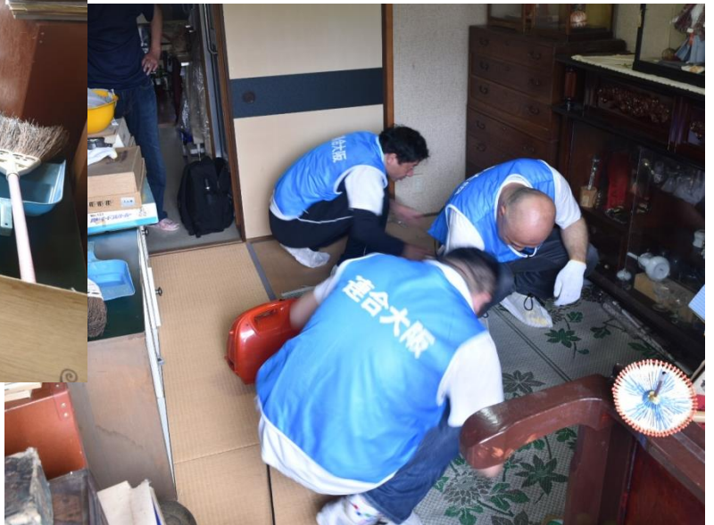
※写真は、被災家屋の片づけの様子
